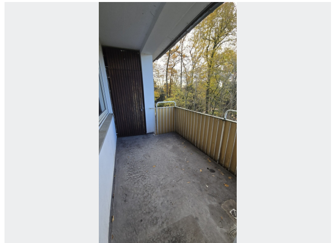
Aktueller Zustand Balkon
